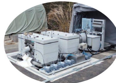
最新設計によるACROSS電源装置 基礎や電源のローコスト化が図られている。
